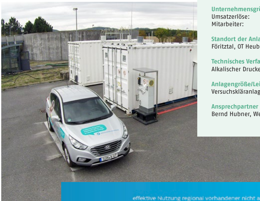
Container Elektrolyseur und Tankstelle © Wasserwerke Sonneberg
