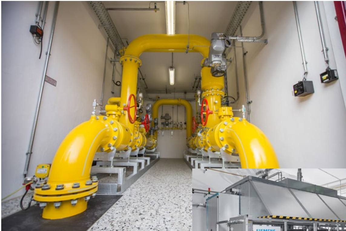
Einweihung der Power-to-Gas-Anlage Quelle: Stadtwerk Haßfurt GmbH
